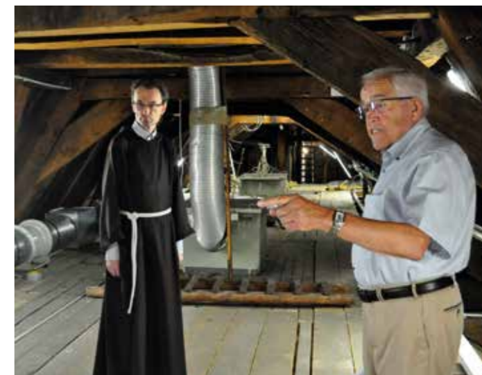
Pater Romuald und Heinz Üttermeier begutachten die neue Belüftungsanlage im Dachgeschoss.
